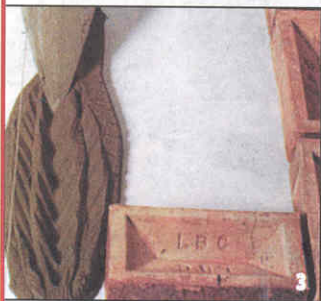
Рывками подают кельму назад, чтобы раствор лег на площадку в виде груши. Расстилают раствор, проводя острием кельмы по его середине.
