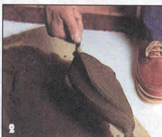
Придают порции раствора форму слегка изогнутого цилиндра, а затем резким движением берут раствор на кельму.
